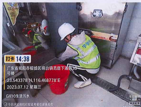
GX10 厨房生活污水
