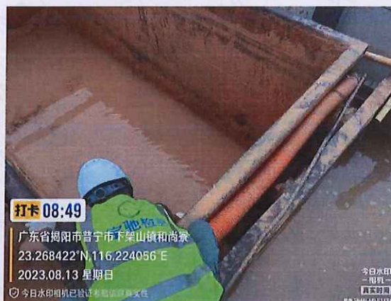
PN17 顶管井生产废水
